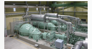
鶴家排水機場に納入した排水ポンプ設備
